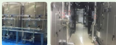
图：纯化水制备系统、空调热管
