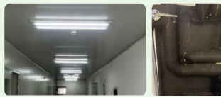
图：厂区 LED 灯照明、ECC 节能器
