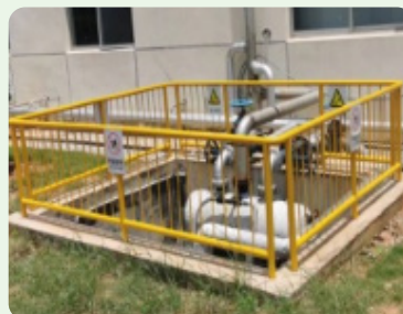
图：洞庭药业工业凝水回收改造
