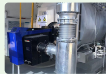
图：万邦复临低氮燃烧器
