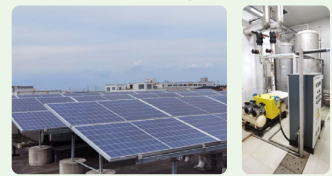
图：光伏发电、中水回用装置
