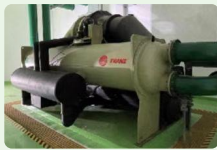
图：磁悬浮机组
